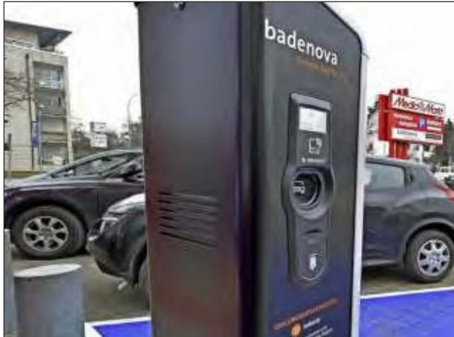
Ladesäule der badenova (Quelle: badenova)
